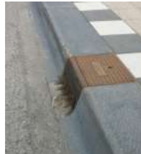
Aanrijdschade en slechte afwatering
