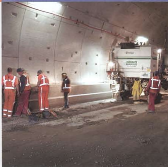
Betonnen voertuigkering in de Westerscheldetunnel
