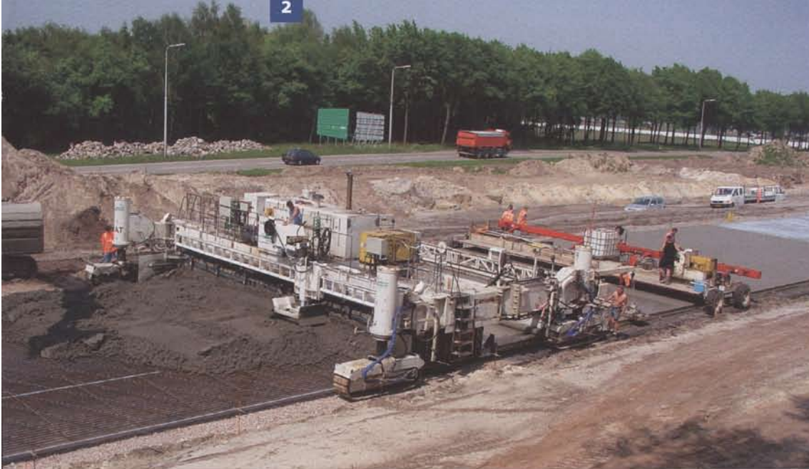
De A50 in uitvoering: het met de slipformpaver aanbrengen van de betonverharding bij Veghel.
